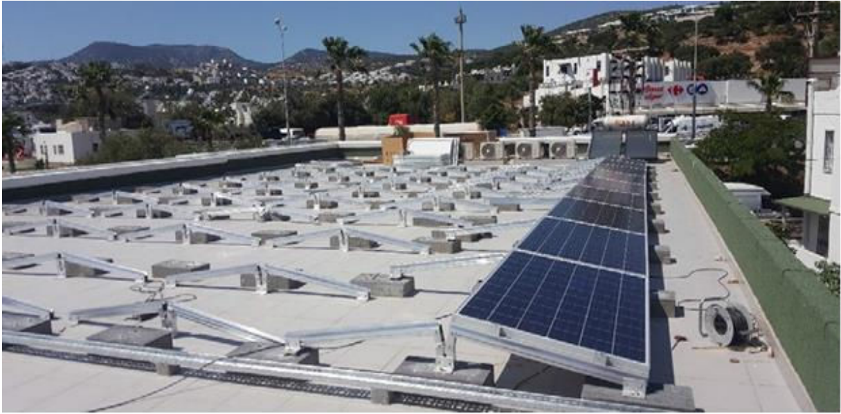
Şekil 2: Çatı tipi PV Panel Modüllerinin Temsili Gösterimi
